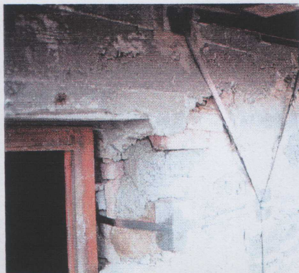
Foto 5: Particolare del collegamento del cordolo di sottotetto e andamento della maglia orizzontale in corrispondenza del vano finestra.
