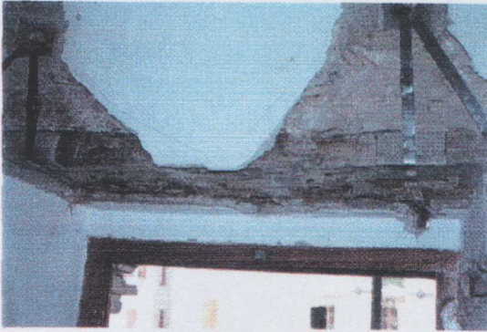
Foto 8: legatura e rinforzo nella zona di architrave di un vano finestra, senza sostituzione dello stesso.
